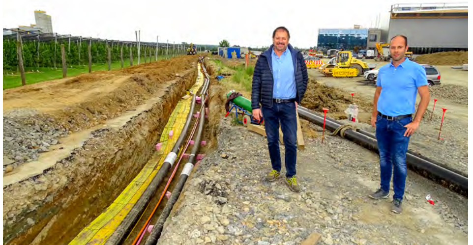
Geschäftsführer Philipp Schuler zeigte sich schon im Sommer hocherfreut über den Baufortschritt für den Nahwärmeanschluss der neuen Produktionshalle.
